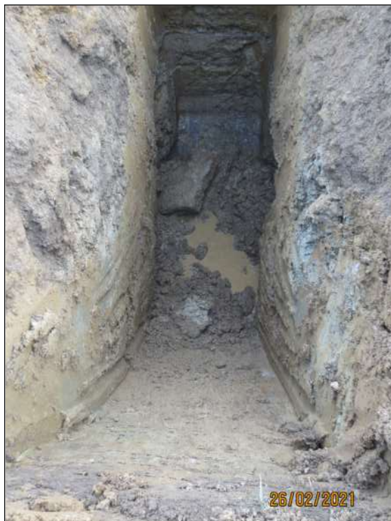
Bild-Nr. 22: Detail von Sch 6 mit starkem Schichten-/Sickerwasserzutritt ab 1,6 m u. GOK.
